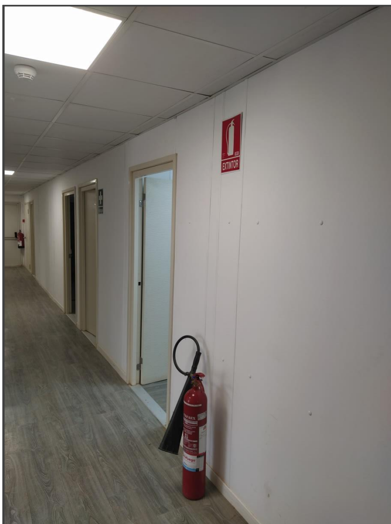
Fotografía 11. Extintores en edificio de control.
